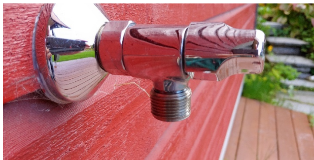
Riktig med åpen kran
